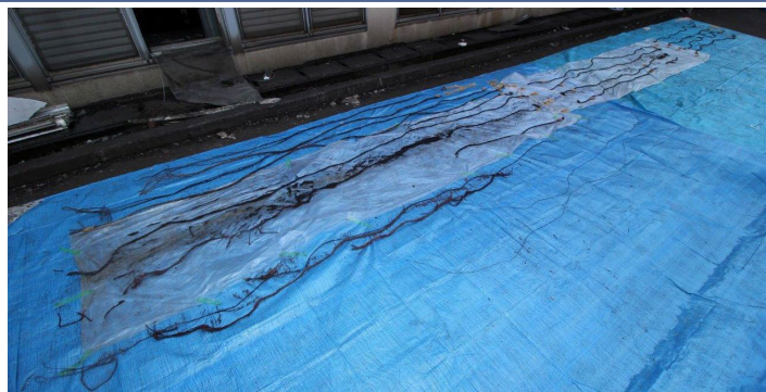
図7：電気配線の見分状況
