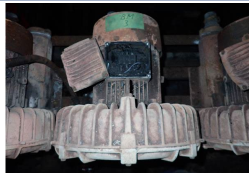
図6：出火場所付近の電気設備見分状況
