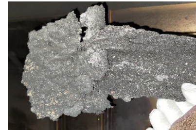
図11：天井から落下した残渣物
