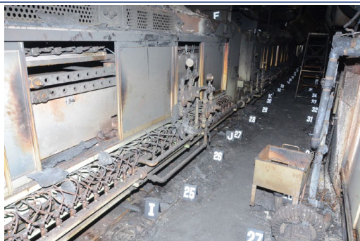
図5：出火場所付近のガス配管見分状況
