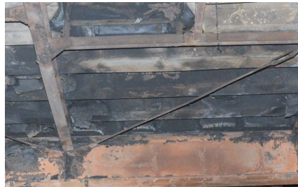
図10：出火箇所付近の天井の様子
